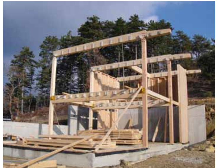
Portiques levés. Panneaux ossature bois posés entre le système poteaux-poutres. Sur chaque grosse poutre, les petites parties métalliques en attente des solivages des planchers et des toitures.
