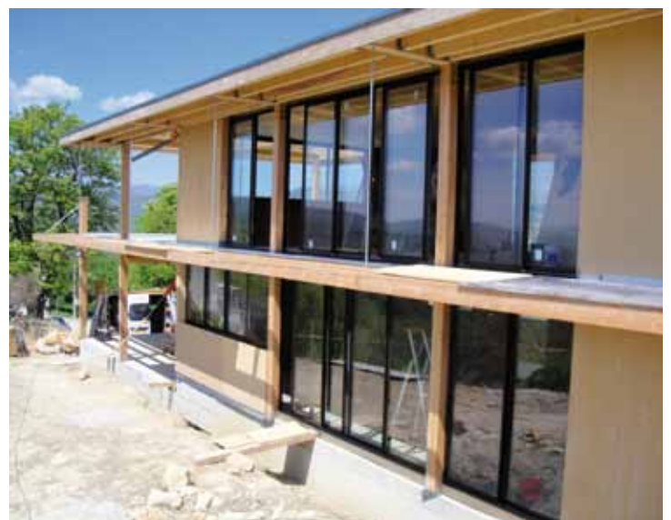
Début de la pose des menuiseries alu-bois ou uniquement bois. Sur la droite, du zinc pour l'étanchéité afin que l'eau ne rentre pas dans les caissons de brise-soleil.
